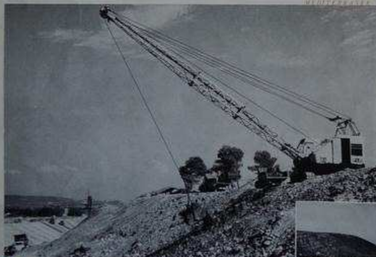
Une grue F. & M. 655 B sur le Canal de Serre de St Estève-Janson.
