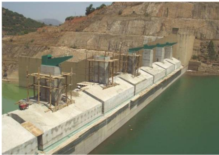
Photo 5- Surélévation à l'aide de hausses fusibles
