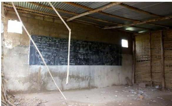
2- État actuel d'une salle de classe de l'école de Mbouloum
