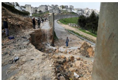
Une partie de la barrière de séparation effondrée, le 27 février 2019. © Reuters
