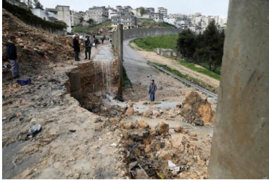
L'effondrement d'une partie de la barrière de séparation après de lourdes pluies, le 27 février 2019. © Reuters
